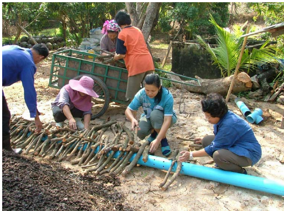
ภาพที่ 9.6 ภาพแสดงท่อ 4 นิ้ว เจาะรู ต่อจากพัดลมเดิมอากาศ ใช้กิ่งไม้วางทับเพื่อระบายอากาศ
